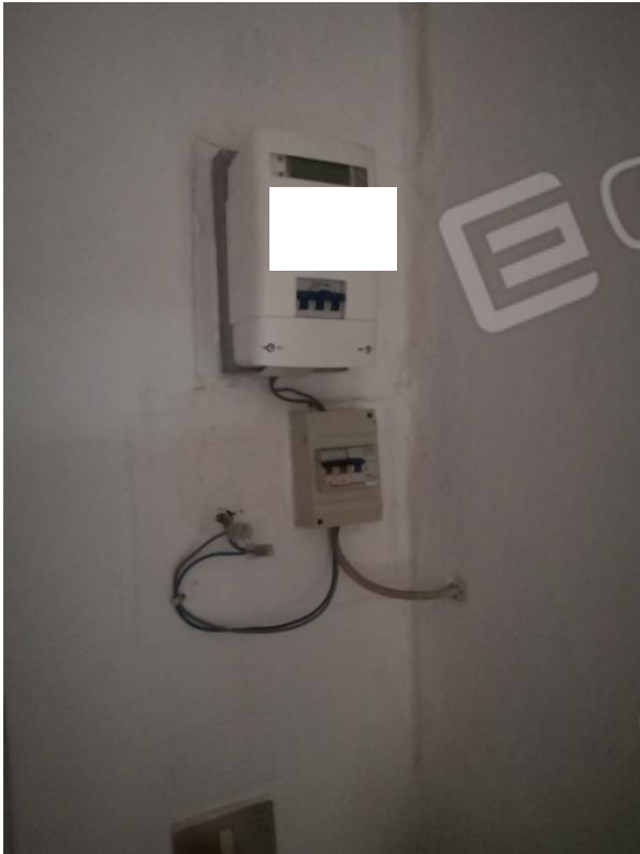
Foto 57 Particolare impianto elettrico
