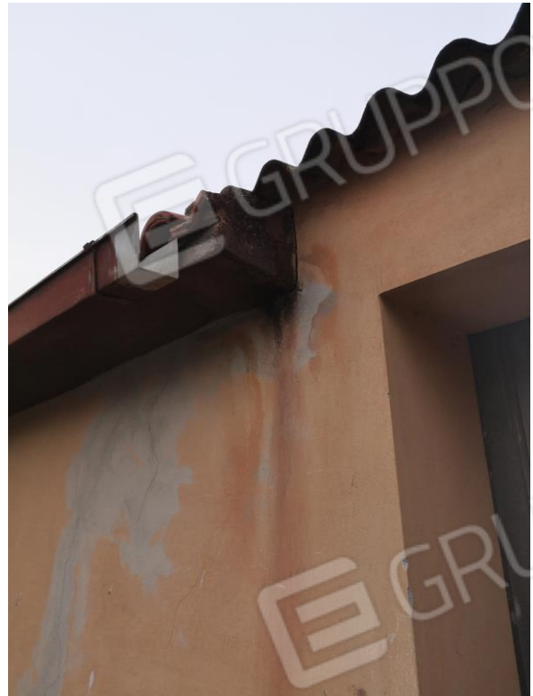
Foto 12 Particolare fessurazioni e muffa facciata
