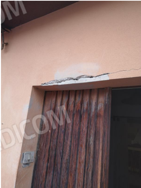
Foto 11 Particolare fessurazioni facciata
