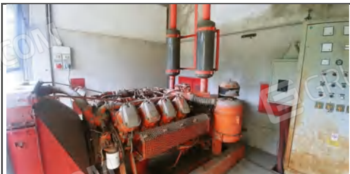
Foto n. 54 – Corpo C – Magazzino mappale 548 – Locale gruppo di continuità
