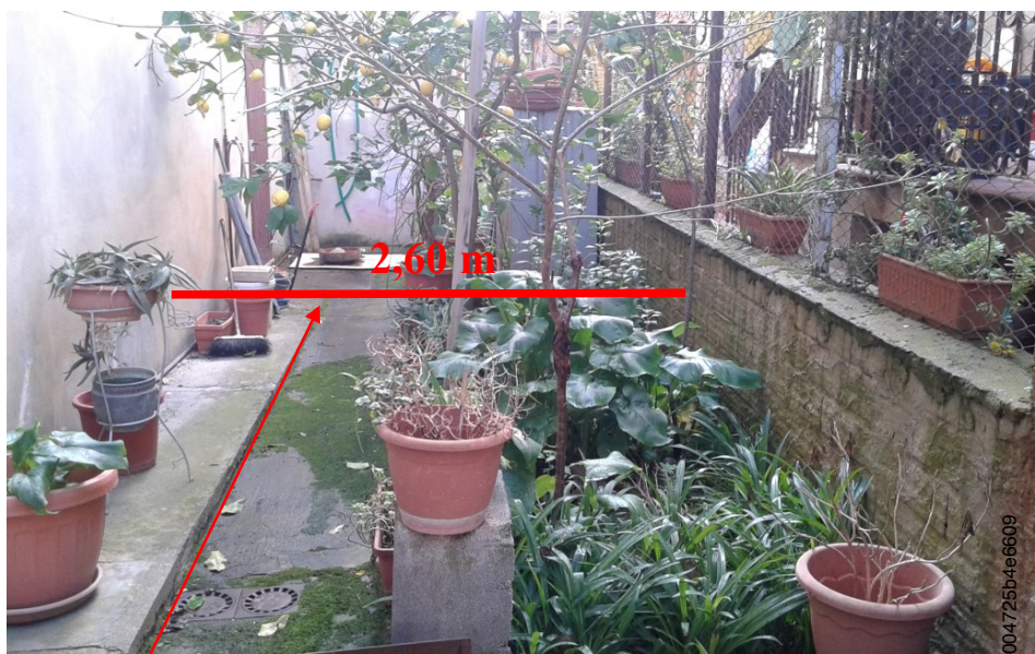
Larghezza della corte rilevata di 2,60 metri a fronte dei 3,20 previsti dalla concessione in sanatoria al Piano Terra
