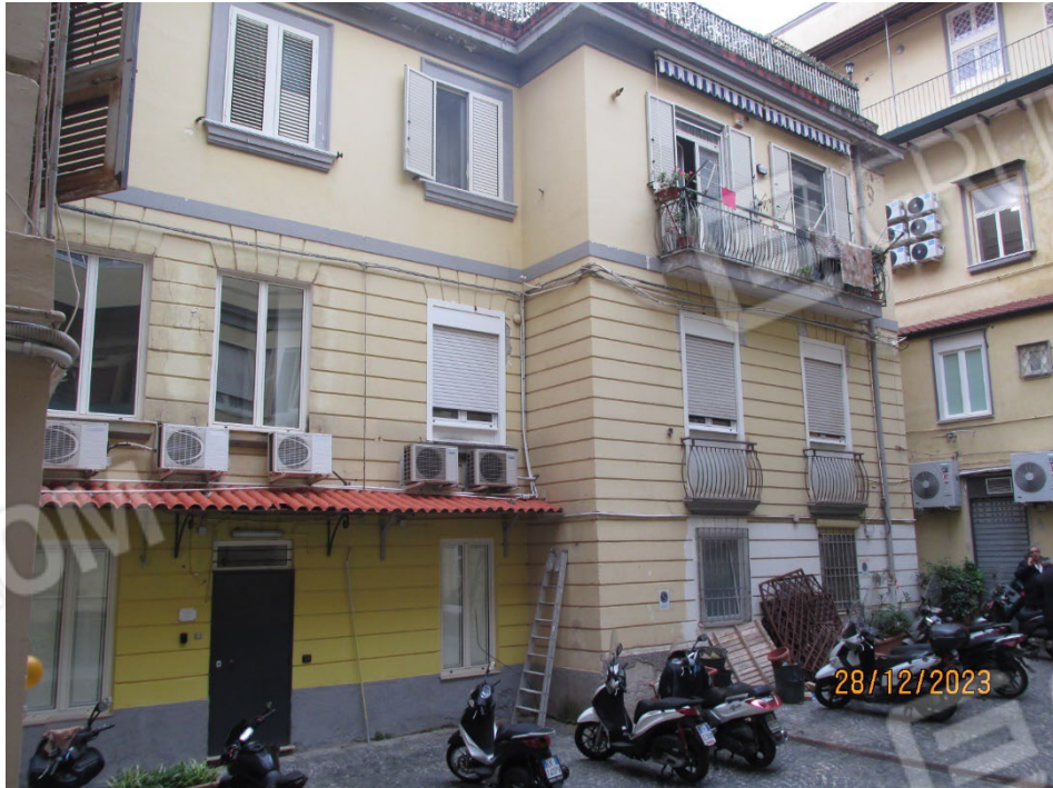
Fotografia 14 – I prospetti del fabbricato che affacciano nel cortile comune presentano le pareti rivestite da intonaci ordinari a finitura liscia e tinteggiate con pittura al quarzo, le balconate risultano costituite da lastre in marmo a sbalzo, ancorate alle pareti con mensole in ferro di sostegno.
