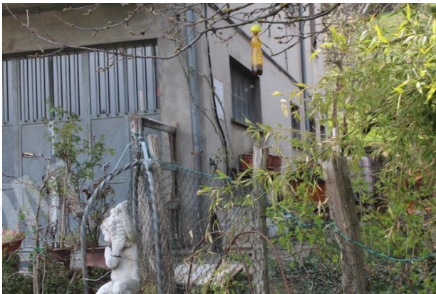
VANO A MURO, CONTATORE ENEL
