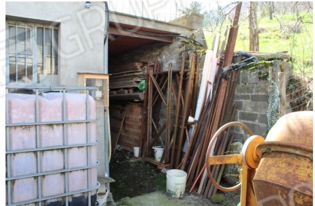
VANO\CAVEDIO AL PIANO TERRA, RICAVATO PER REALIZZAZIONE TERRAZZO AL PIANO PRIMO – ABUSIVO E DA DEMOLIRE
