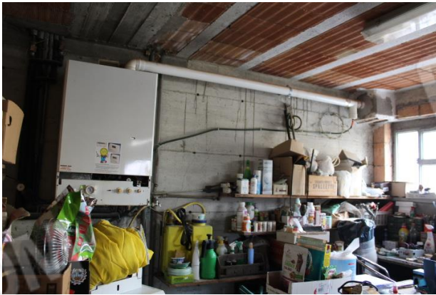
CALDAIA NEL VANO LEGNAIA, NON DELIMITATO DA PARETE CON IL GARAGE
