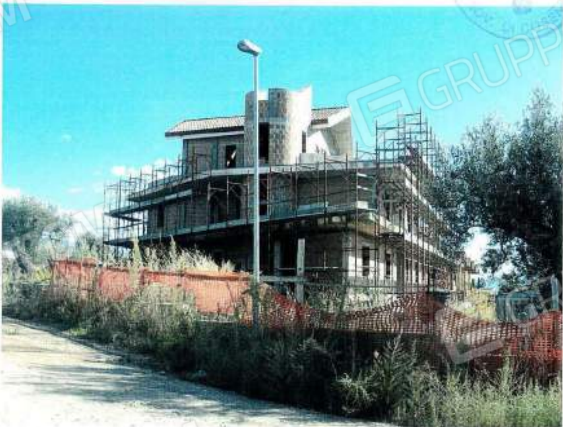
Foto 32 – Cespite n°7: veduta del fabbricato in costruzione in Località Collina Salerno (facciata ovest e nord viste di scorcio)
