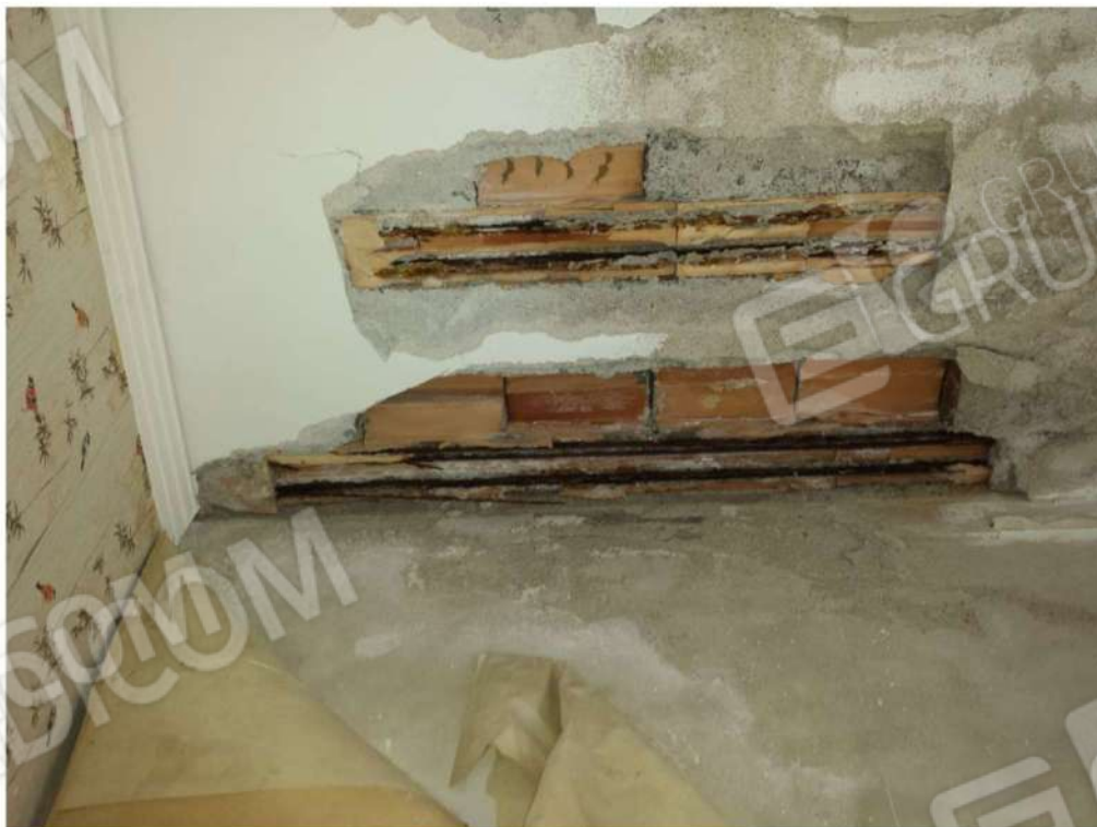
Foto n. 152: Danni al solaio causati dalle infiltrazioni di acque meteoriche provenienti dalla copertura dell'immobile sito nel comune di Maida (lotto n. 6).
