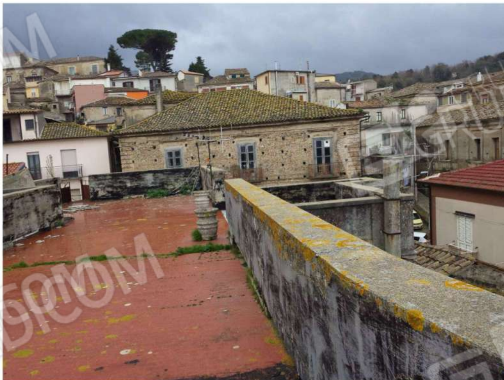
Foto n. 154: Copertura piana dalla quale provengono le infiltrazioni di acqua meteorica riscontrate al primo piano (secondo fuori terra) dell'immobile sito nel comune di Maida (lotto n. 6).
