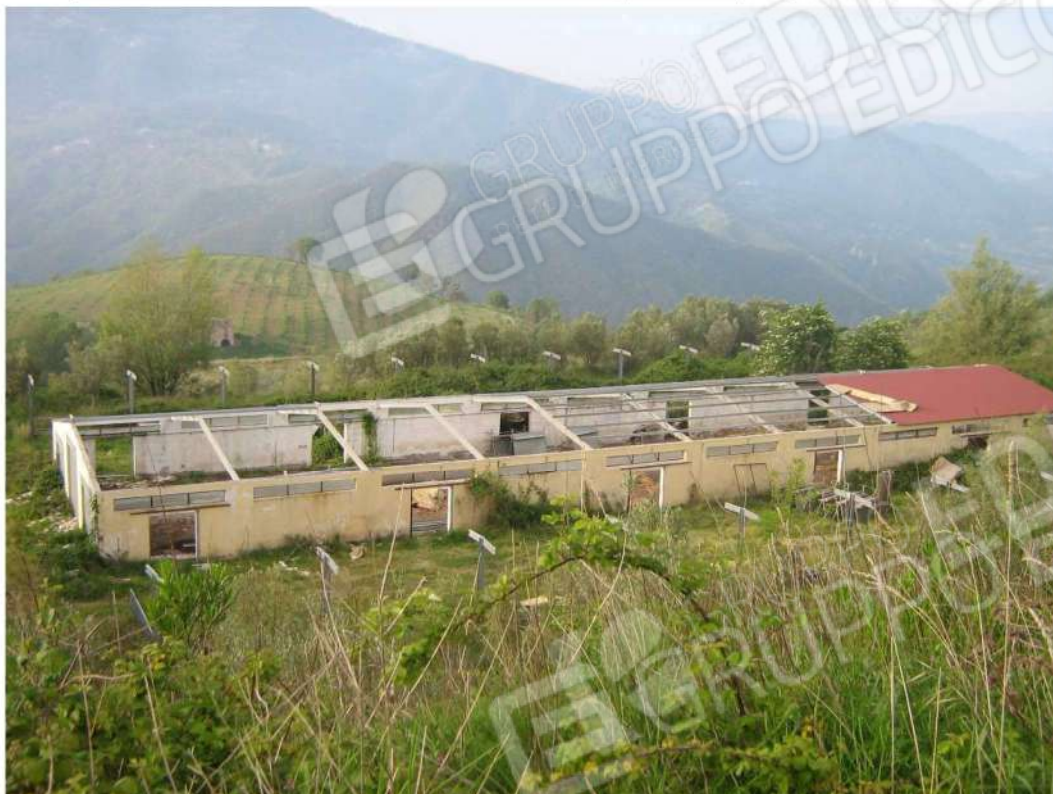
Foto n. 79: foto prospettica fabbricato “E” adibito ad allevamento – da notare che la struttura di copertura è stata oggetto di furto (lotto n. 4).
