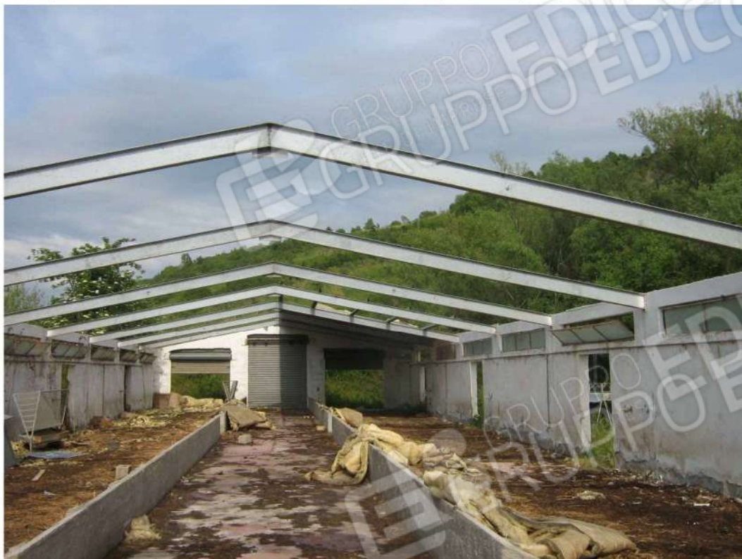
Foto n. 85: particolare struttura di copertura - foto scattata in data 6 maggio 2008 ; da osservare che gli arcarecci, di cui alla fotografia n. 83 sopra riportata, sono stati rimossi - Fabbricato "E" (lotto n. 4).
