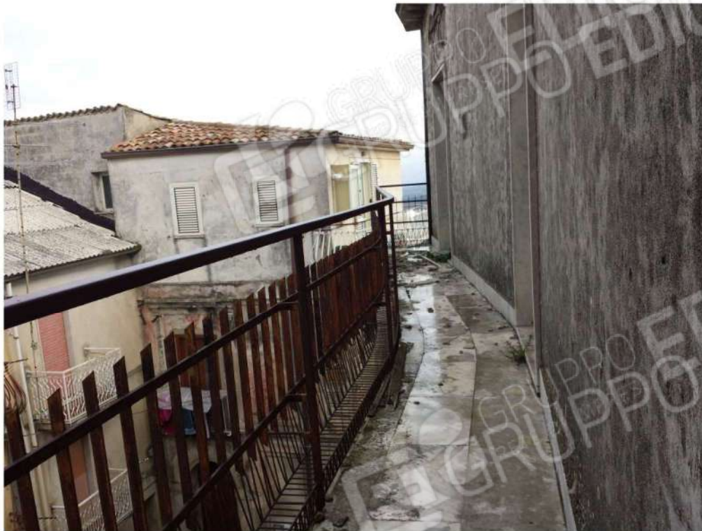
Foto n. 155: Balcone ubicato al primo piano (secondo fuori terra) sul prospetto Ovest dell'immobile sito nel comune di Maida (lotto n. 6); si nota la presenza di calcinacci.
