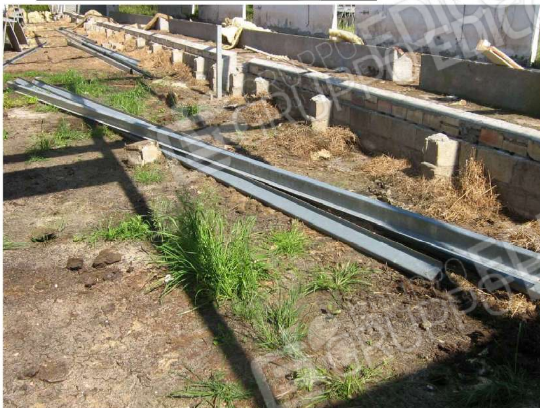
Foto n. 97: particolare arcarecci rimossi dalla struttura di copertura - foto scattata in data 2 maggio 2008 - Fabbricato "E" (lotto n. 4).
