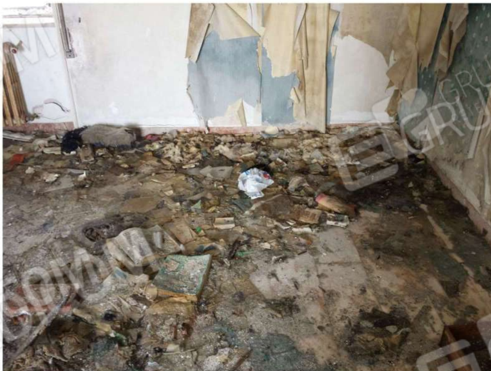
Foto n. 150: Materiale vario (degradato a causa delle infiltrazioni provenienti dalla copertura) depositato al piano primo dell'immobile sito nel comune di Maida (lotto n. 6).
