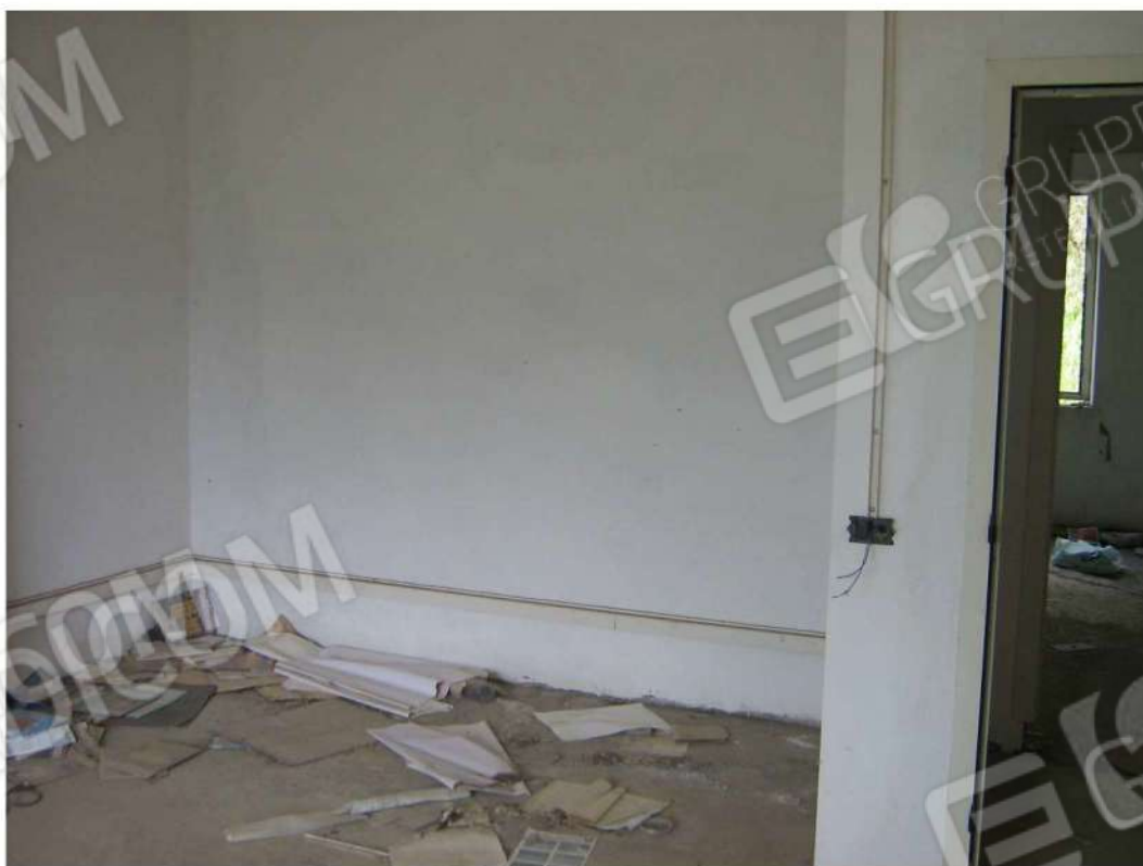
Foto n. 36: particolare vano posto al piano terra; da notare che gli ambienti del piano in esame sono dotati di intonaco - Fabbricato "A" (lotto n. 4).
